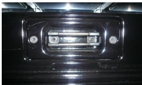
Figura n°32 - Accessi per la pulizia dello scarico fumi.
