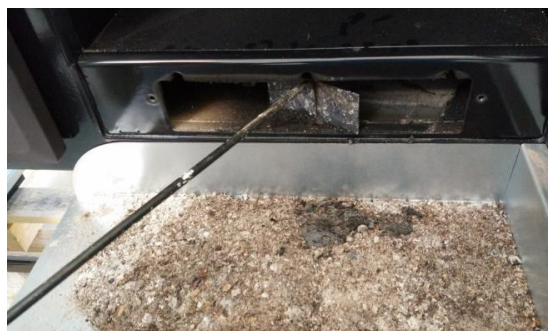
Figura n°21 - Accessi per la pulizia dello scarico fumi.
