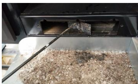
Figura n°22 - Accessi per la pulizia dello scarico fumi.
