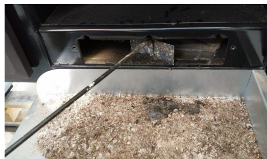
Figura n°20 - Accessi per la pulizia dello scarico fumi.
