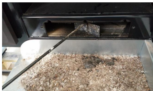
Figura n°20 - Accessi per la pulizia dello scarico fumi.
