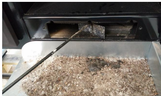
Figura n°24 - Accessi per la pulizia dello scarico fumi.
