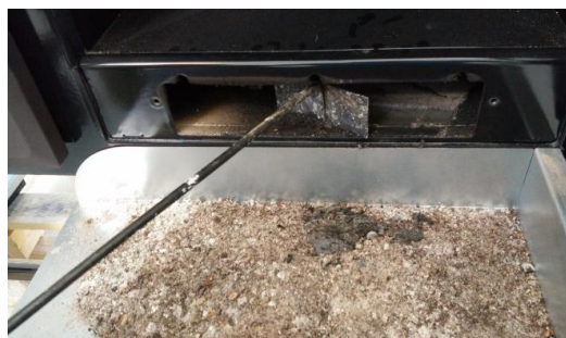
Figura n°22 - Accessi per la pulizia dello scarico fumi.
