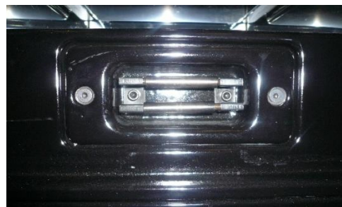
Figura nº30 - Acessos para a limpeza da saída de fumos.
