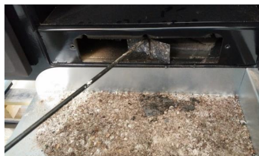
Abbildung Nr.18 - Zugänge zum Reinigen des Rauchabzugs.
